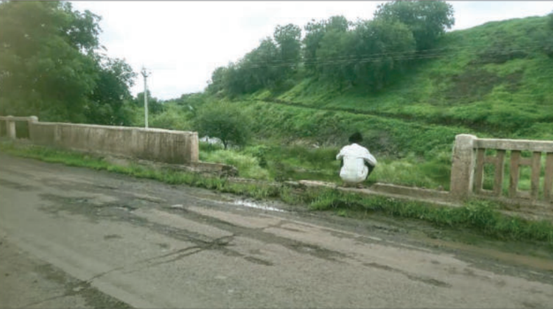
ग्राम घुघरी के पास बने पुल की रेलिंग की जर्जर स्थिति।
