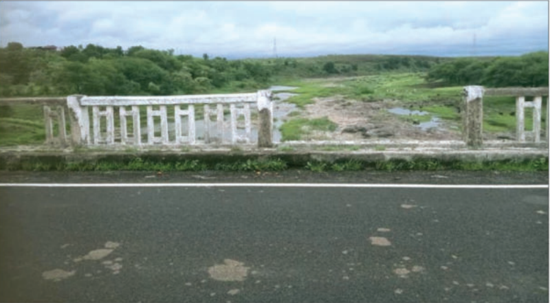
लाड़की नदी की जर्जर रेलिंग।
